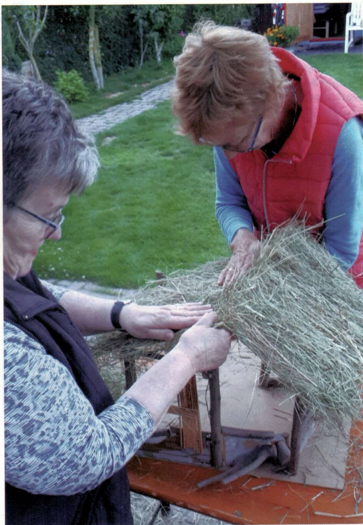
Der Stall muss ein neues Dach haben: Trude Gall (links) und Mausli von Rauchhaupt decken mit Stroh ein.
